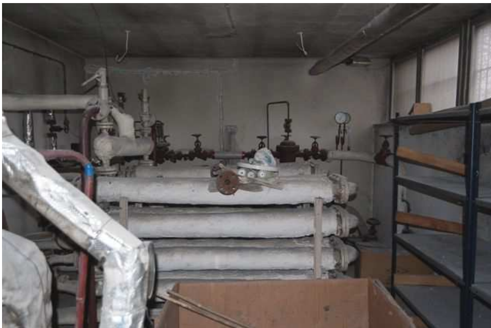
Fot. 1 – Pomieszczenie wymiennikowi
