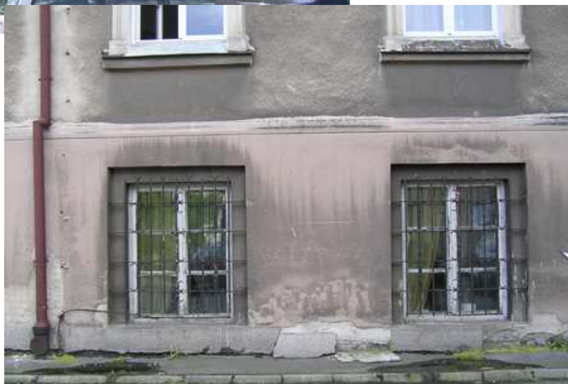
Fot. nr 12-13 - Lublin, ul. Spokojna 4. Widok ogólny elewacji północnej od strony ul. Spokojnej oraz uszkodzenia cokołu, korozji tynków i obróbek.
